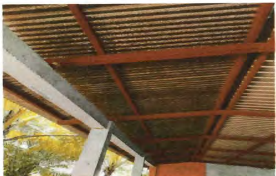
MODULO III: Se observa una parte del entechado que tiene laminas acanaladas y estan en mal estado, es ahí la sustitución de laminas troqueladas.
