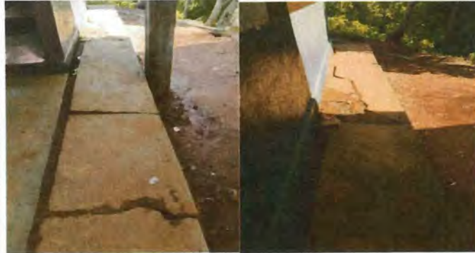
MODULO II: Se observa el deterioro de las banquetas, es ahí donde se necesita sustitución.
