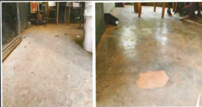
MODULO I: Se observa que el piso de las aulas es rústica, es ahí donde es necesaria la sustitución por piso cerámico.
