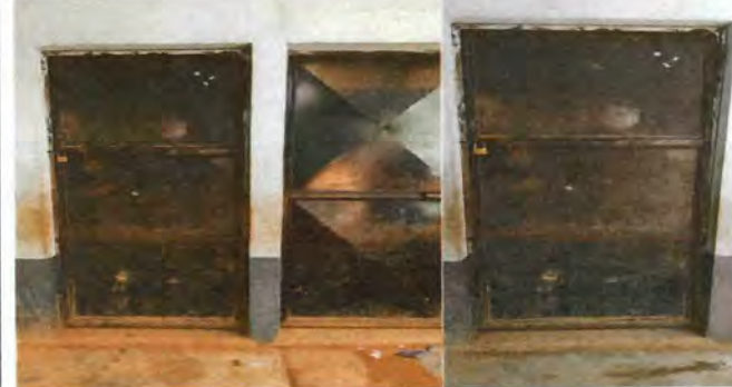
MODULO IV: Se observa que las puertas necesitan mantenimiento, lijada, pintura y chapa. (4 puertas)
